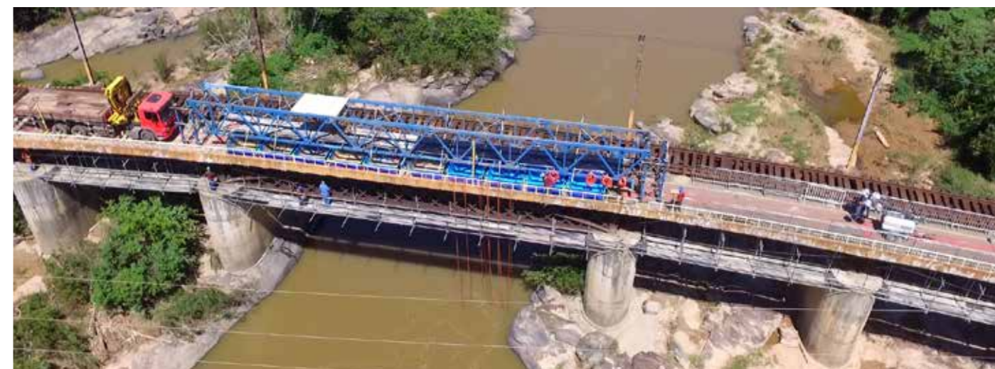
Vista superior da montagem das estruturas e reservatórios de água para prova de carga.
